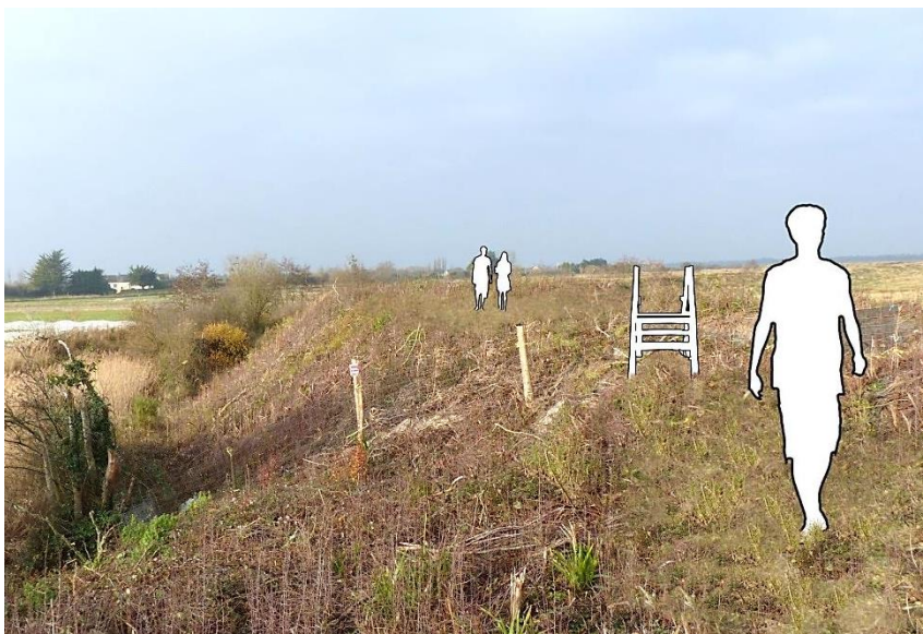
Tronçon CD : nécessite l'installation de plusieurs passages d'homme car la digue sert de zone de repli pour les moutons
