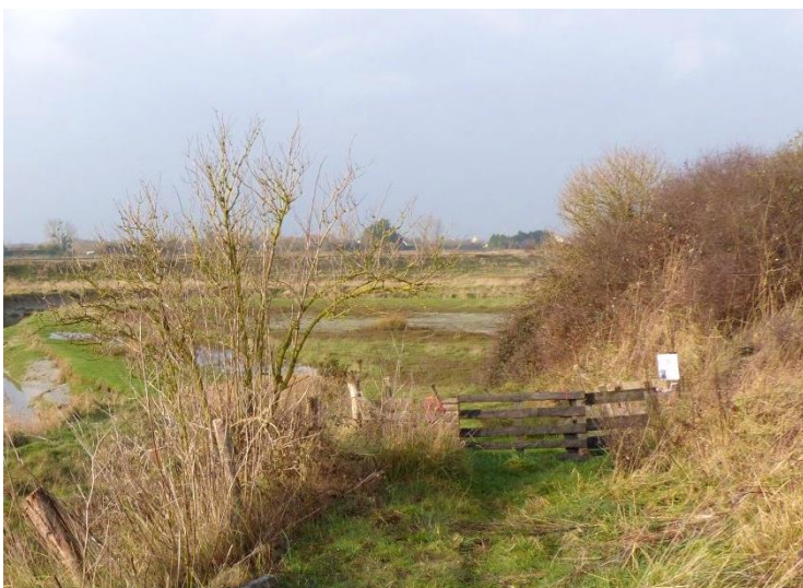
Tronçon AB : nécessite l'installation d'un passage d'homme
