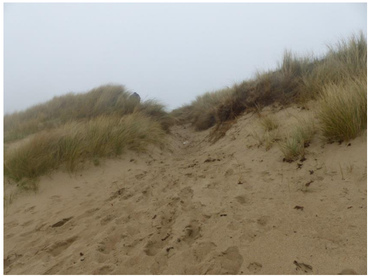
Tronçon AB : brèche à combler pour pérenniser le chemin derrière
