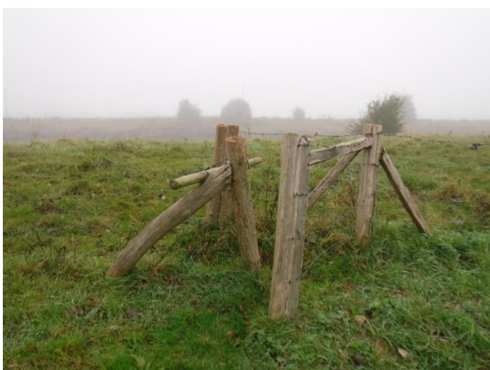
Passage d'homme à remplacer sur la digue côté pont de la Barquette
